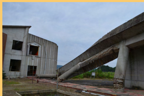
体育館へと続く倒壊した渡り廊下
