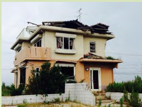
屋根の上に他の家の屋根瓦が重なっている家屋。
